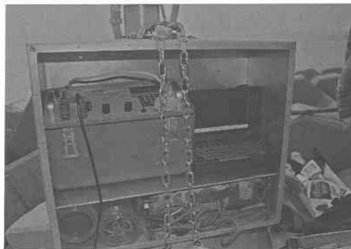
写真二 防波堤上に設置した受信機 (待ち受け型 I)
