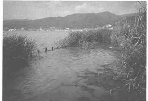
写真-3 無植生部分背後の湖岸浸食 (その1)
