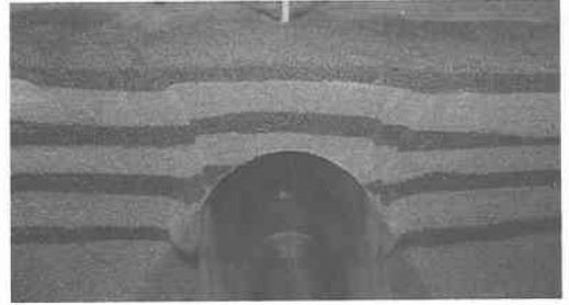
写真-1 静的なパイプの浮上の状況
