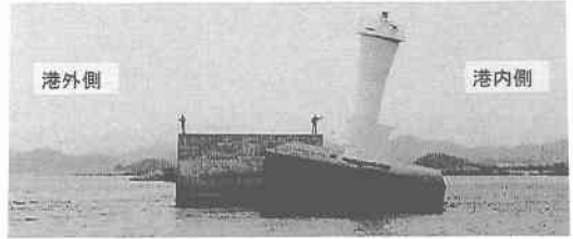
写真-2 堤頭部ケーソンのマウンド散乱による傾斜
