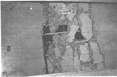
写真-2 破壊状況
