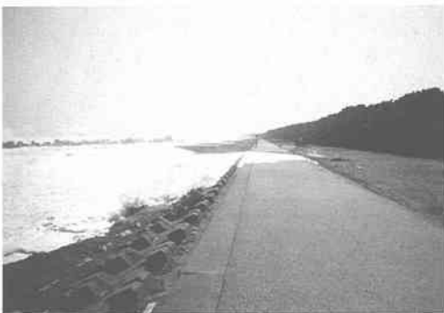
写真-2 台風 9805 号による越波浸水被害状況
