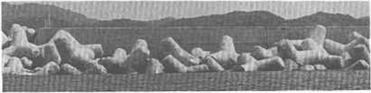
写真-1 消波ブロック被覆堤の被災例
