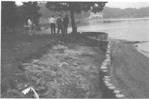
写真-1 親沢鼻先端の木製護岸と背後の侵食状況
