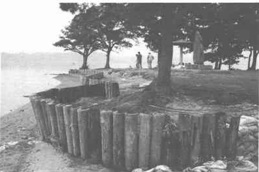
写真-2 親沢鼻東岸の木製護岸と背後の松の被害状況
