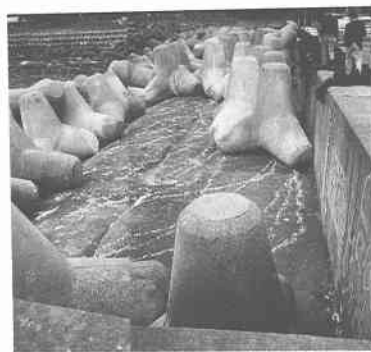
写真-4 南防波堤消波ブロック移動、散乱状況
