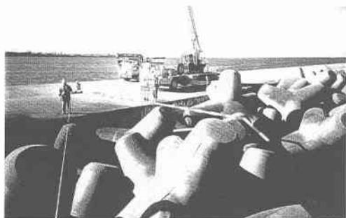
写真-3 鹿島港被災状況 (1996/9)
