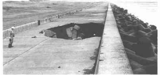
写真-1 護岸天端の陥没
