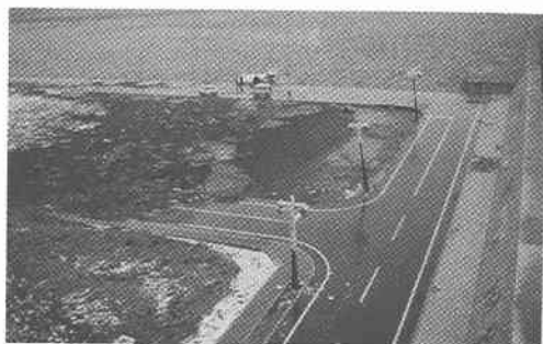
写真-1 護岸背後の被災状況
