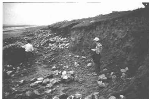
写真-2 堤防の被災状況 (95 年 5 月)
