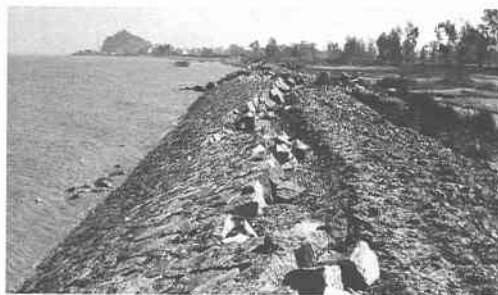
写真-5 石張りの海岸堤防の被災
