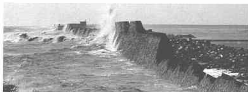
写真-8(a) 東シナ海に面する海岸堤防の被災状況
