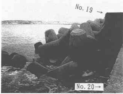
写真-1 八戸港中央第2防波堤被災状況 (No. 19, 20 ケーソン前面)
