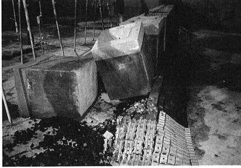
写真-3 東外防波堤のマウンド破壊とケーソンの倒壊
