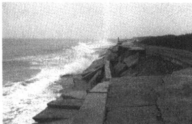
写真-3 測線 No. 124 付近の海岸堤防の被災状況 (1992年9月)
