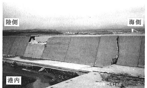
写真-3 青苗漁港北防波堤の一部折損
