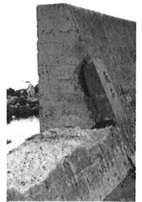
写真-2 打設不良の例
