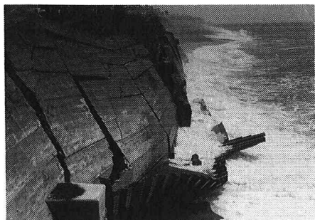
写真-3 海岸護岸の被災状況（7月30日）
