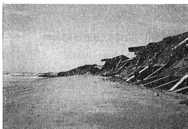
写真-7 堤防の被災状況 (2)
