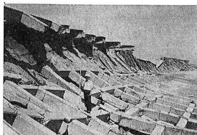
写真-6 堤防の被災状況 (1)
