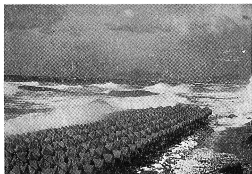
写真-3 三豊干拓消波工飛沫発生状況
