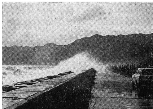
写真-4 隣接海岸消波工越波状況
