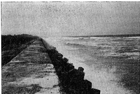
写真-1 磯浜漁港北側の海岸侵食状況
