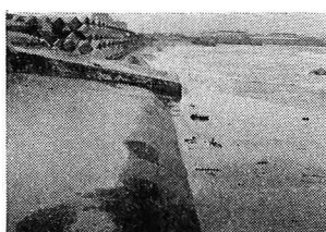
写真—2 護岸の洗掘防止用マット
