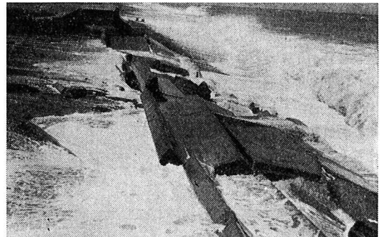
写真—1 傾斜式コンクリート被覆堤防の破堤
