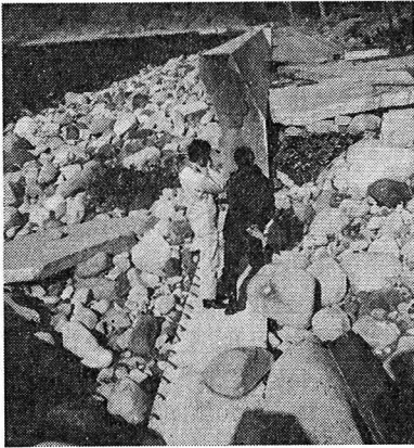
写真-8 井田海岸護岸被災状況
