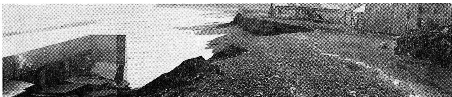
写真-2 被災状況 (昭和50年4月撮影)
