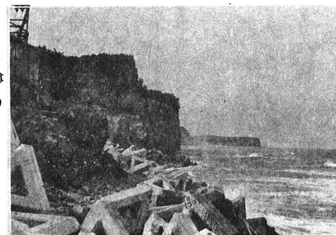
写真-8 挟砂層侵食によって形成された垂直崖(台の山T入口付近)
