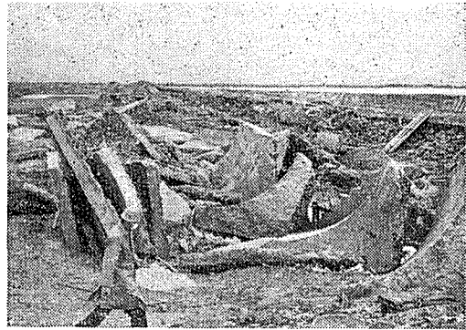
写真—4 天端未舗装のため全面欠潰した 康衛新田の干拓堤防
