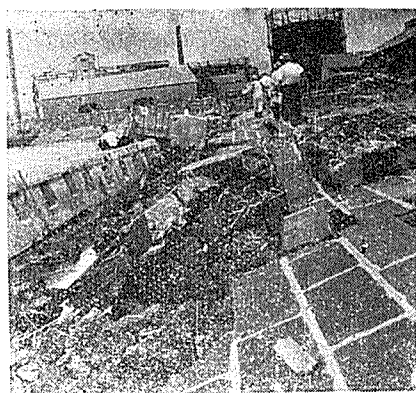
図-24 鹿兒島港外碇米護岸の破壊状況
