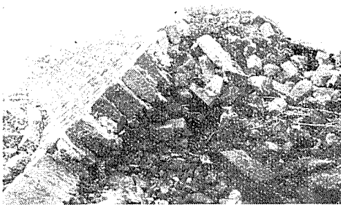
図-6 鹿児島港三五郎防波堤の破壊状況
