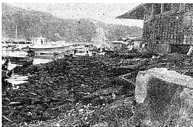
図-25 鹿兒島縣山川港の護岸破壊状況
