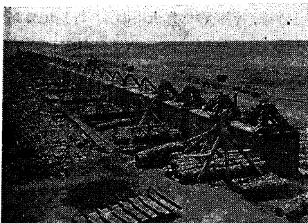
写真第 58 合掌拵付コンクリートブロック水制（護岸前衛の平行工）
