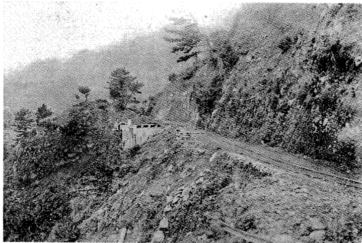
静岡県 熱海小田原線熱海町地内鉄筋混凝土棧道及び道路崩壊箇所
