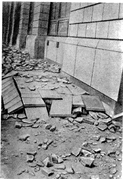
東京市 歩道被害状況(其五) (丸ノ内ビル ディング沿ひ)
