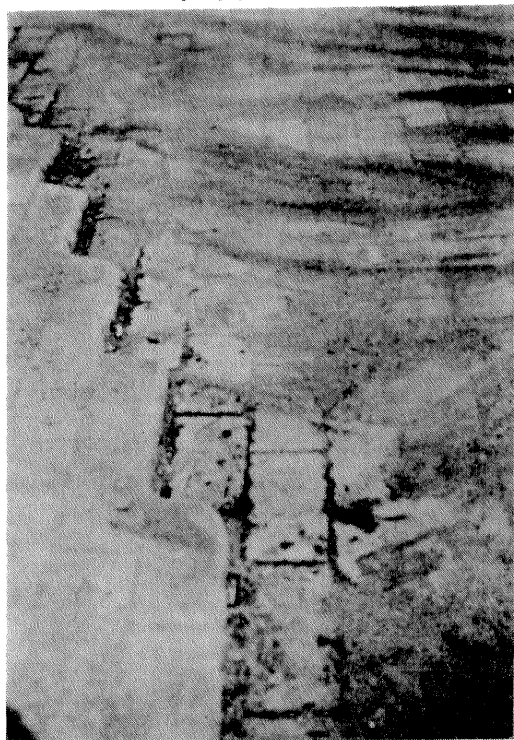
東京市 歩道被害状況(其三) (丸ノ内ビル ディング沿ひ)
