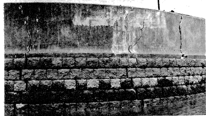
東京市深川區濱園町海岸の鐵筋混凝土護岸の被害
