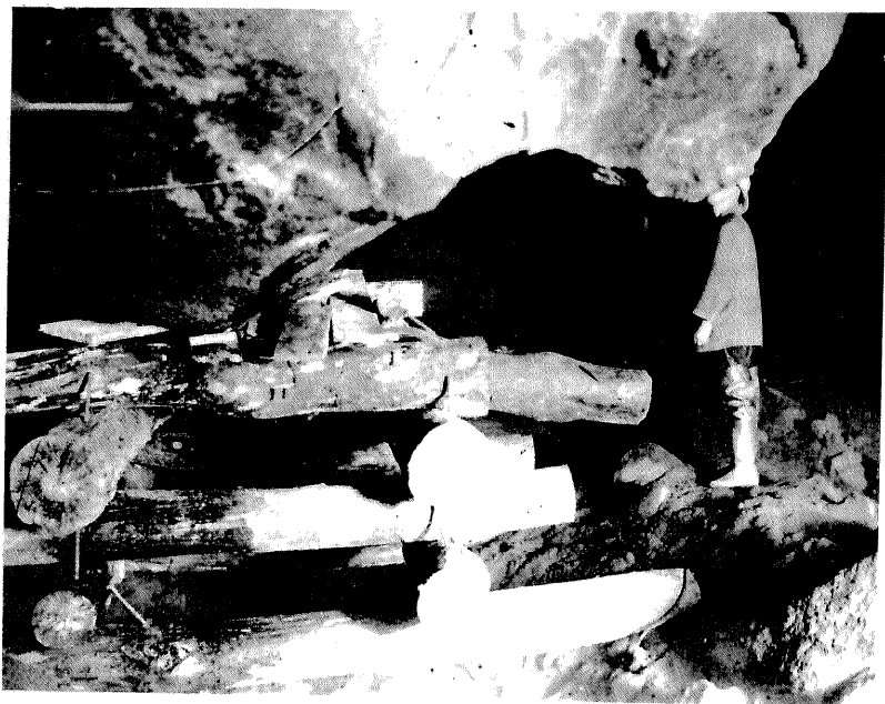
三島口砂層内に出来た大空洞の一部
