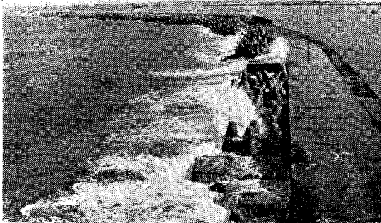
写真-3 4t テトラポッドで補強した防波堤 (昭.33.10.7)
