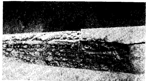
写真—1 桁橋主鉄筋の腐食ならびにかぶりコンクリートの剝落状況
