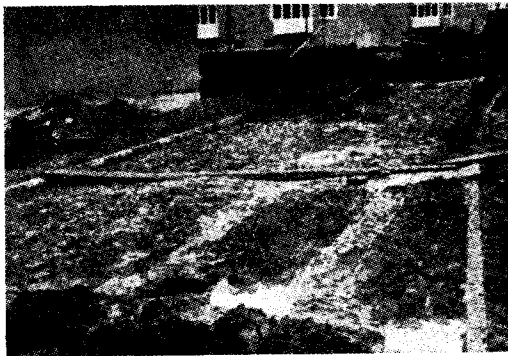
写真-5 降雨後の路盤(安定処理不能)
