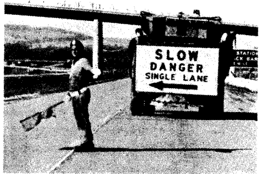
写真-4 ニューヨーク・ステート・スルーウェイ 補修工事の際の信号手とトラックにつけられた警戒標識
