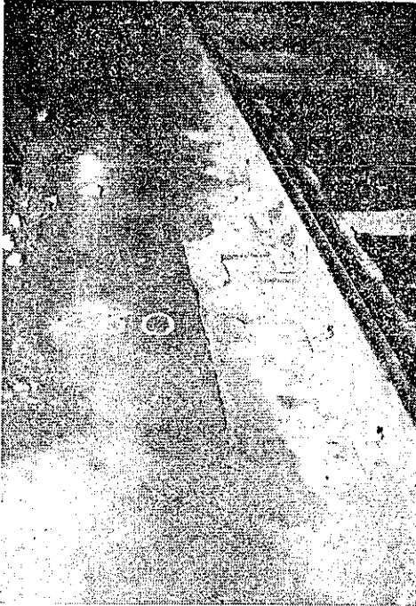
圖-22. 枕木の外側の道床コンクリートの幅の不足に起因する道床コンクリートの破壊例 (鶴瀬隧道其の 1)
