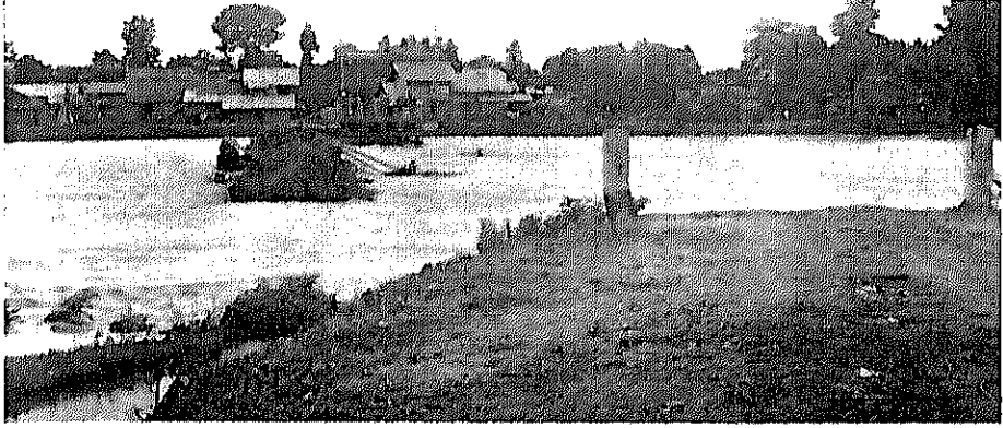
吹上・黒石線浅井橋軸欠潰の狀況 (南津輕郡尾崎村大字浅井地内)
