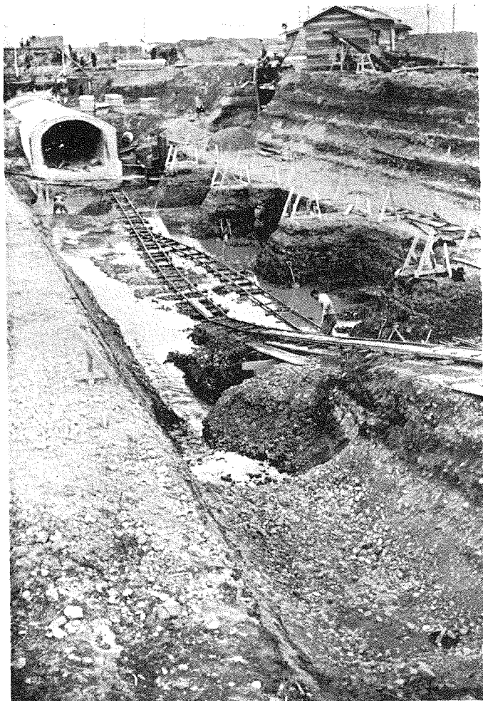
5. 沈砂池より唧筒場へ至る 導水渠 幅3.40米、高2.70米、馬蹄 形鐵筋混凝土暗渠。
