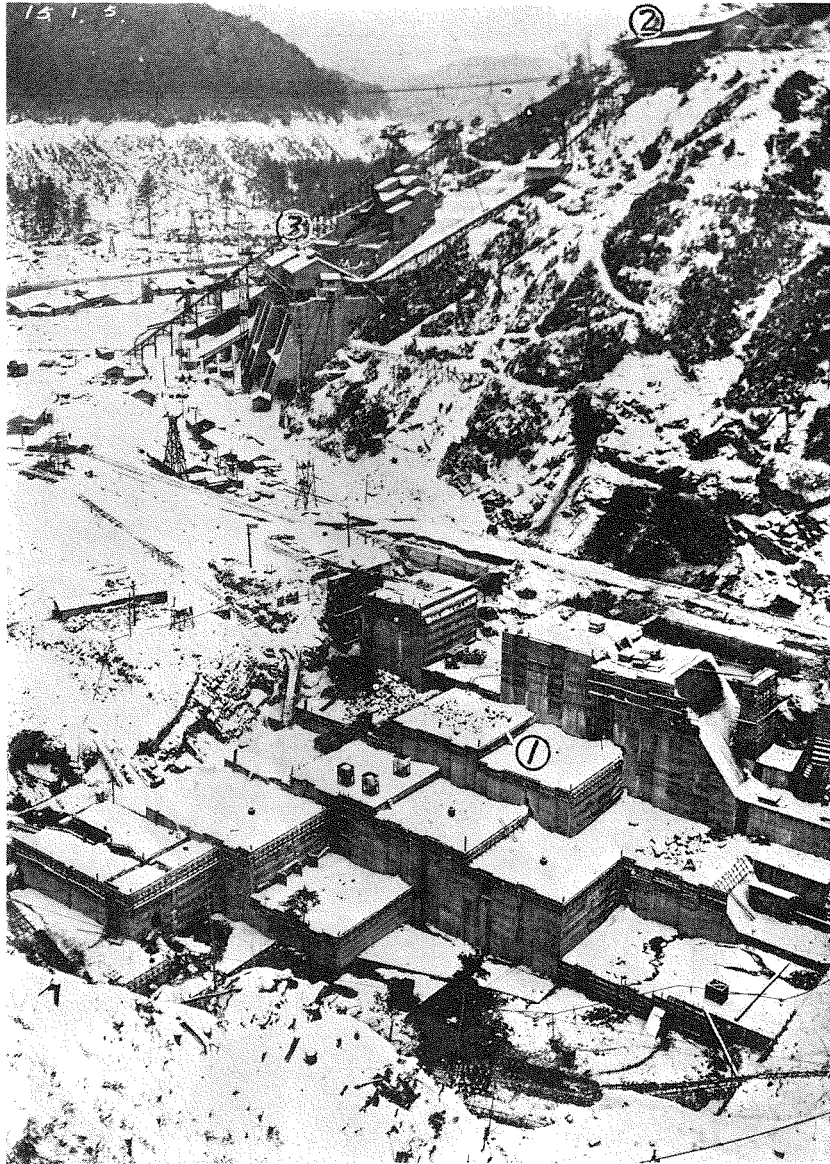
寫眞2. 三浦貯水池右岸下流より見たる堰堤工事狀況(15.1.5 現狀) (1)堰堤(2)セメント倉庫(3)混合工場
