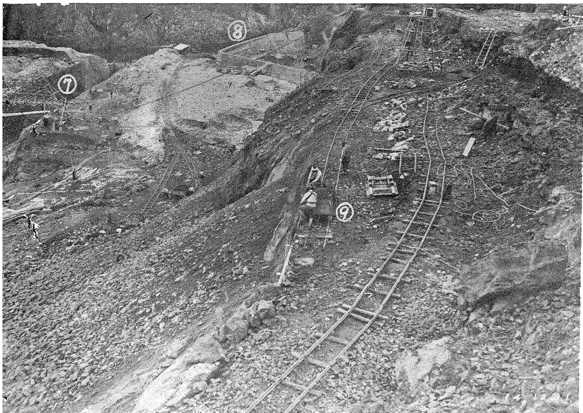
合工場(6)堰堤排水路掘鑿 (7)掘鑿略々完了せる排水路 (8)放水路締切混凝土 (9)取水口掘鑿
