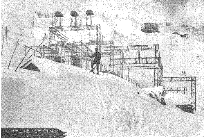
17. 雪中の屋外變電所より水槽を望む。
