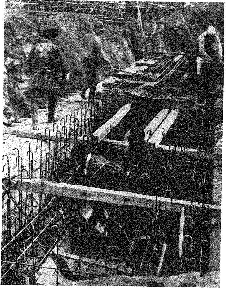
(5) 桁下部主鉄筋 下部のコンクリート 施工状況、電気 式コンクリート振 動器使用中。
