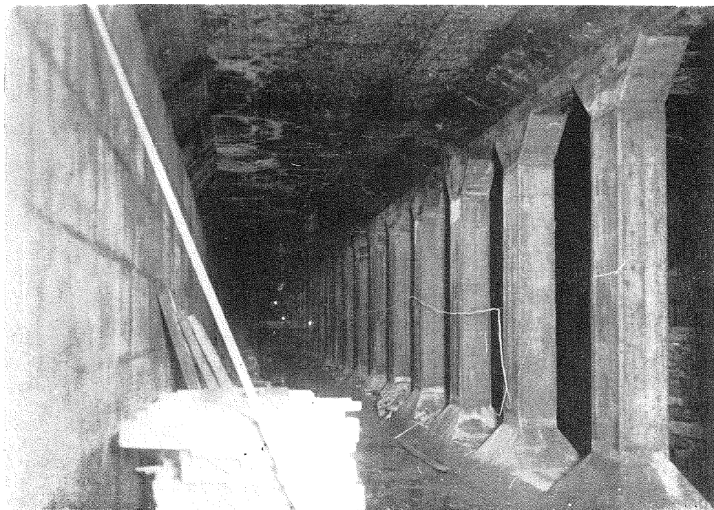
(12) 完成せる隧道の一部、第1工區間佐久間町附近、6月末の工程約300米。
