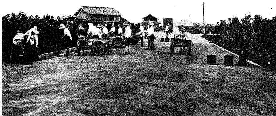
(16) 稲葉郡鶉村地内、アスファルト乳劑舗装仕上げ工事の實況。
