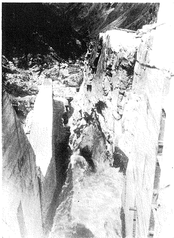
(4) 白岩堰堤工事・9年7月の出水により堰堤水通欠壞す。下が水抜である。
