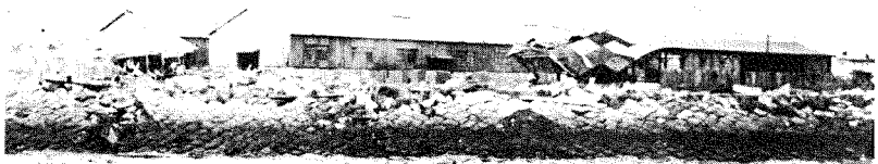
(22) 飛行場護岸、間知石空積みで裏詰は全部砂であつた。砂が洗はれて破壊した。
