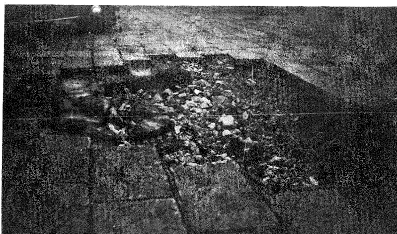
○ (15) 神戸港第四 突堤の被害。 ○
