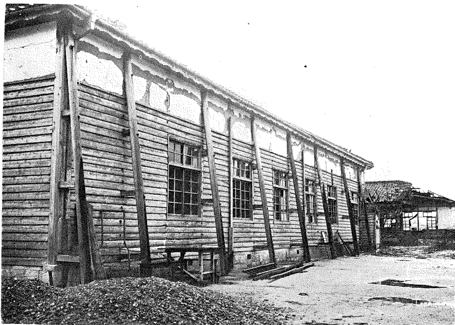
(13) 控柱があつた爲倒壊を免れた大庄村小學校。
